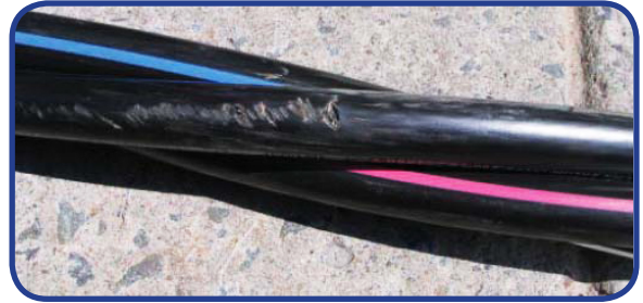
Ví dụ về vỏ bọc bị hư hại trên cáp điện hạ thế được định vị bằng thiết bị thử nghiệm cách điện cáp
